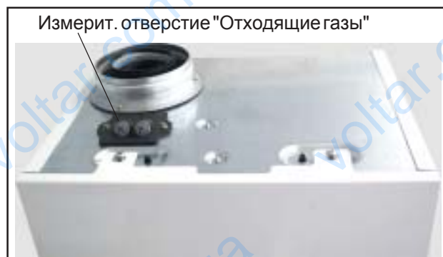
рис.: Измерение отходящих газов на котле с одетой обшивкой
