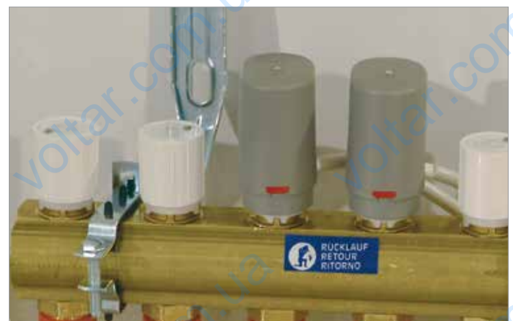
Рисунок 9. Электротермические сервоприводы, установленные на коллектор.
