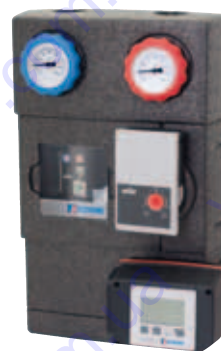
ESBE серия GBC200 С готовым к работе контроллером 90C-3, который установлен на насосную группу.
